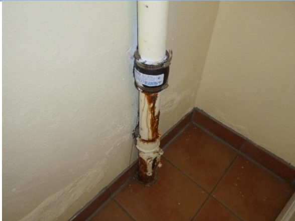
Korrosion i avloppstam i tvättstuga
