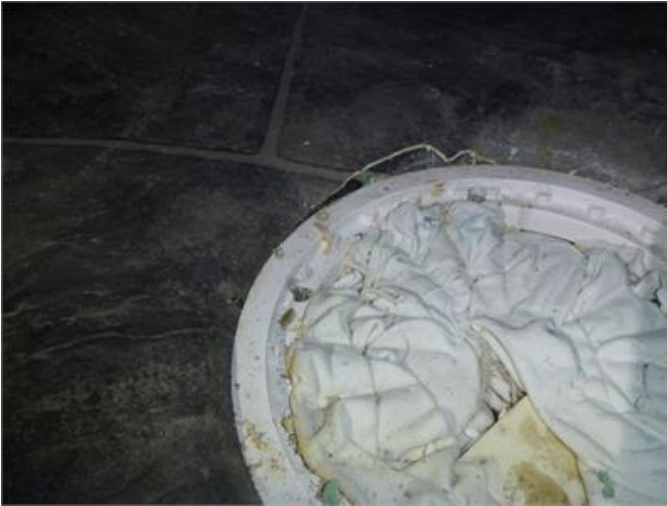
Skador i duschens tätskikt på övre plan
