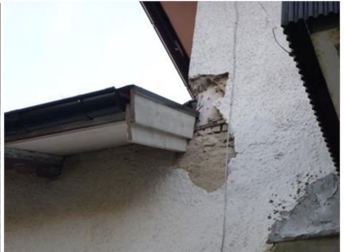
Brister och skador i fasaden av puts
