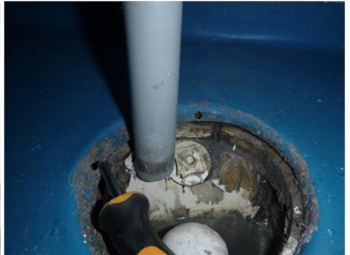
Golvmattan har krympt ur klämringen i tvättstugans golvbrunn. Mattan är också skadad
