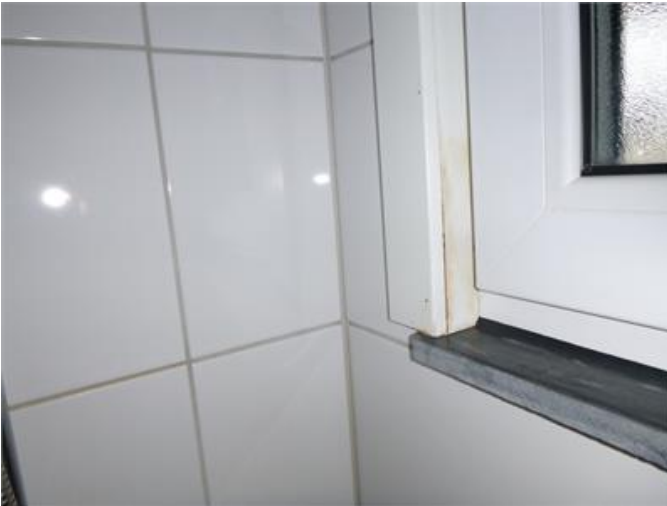
Fönstret beläget i duschdelen med skadade trädetaljer
