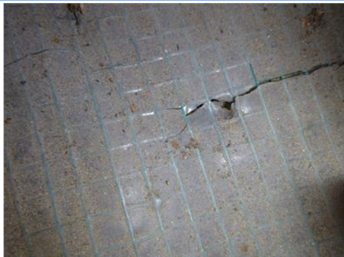
Sprickor i underlagstak av fiberarmerad plast
