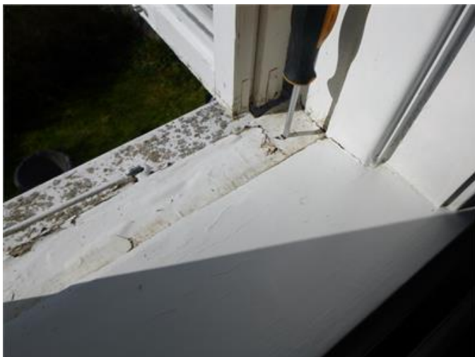
Rötskador kring fönsterparti på övre plan
