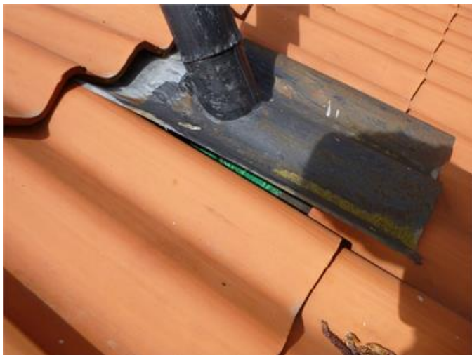
Bristfällig plåtning kring avloppsluftning
